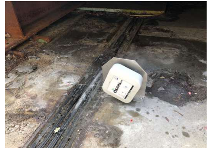
橋梁の遊間部監視
