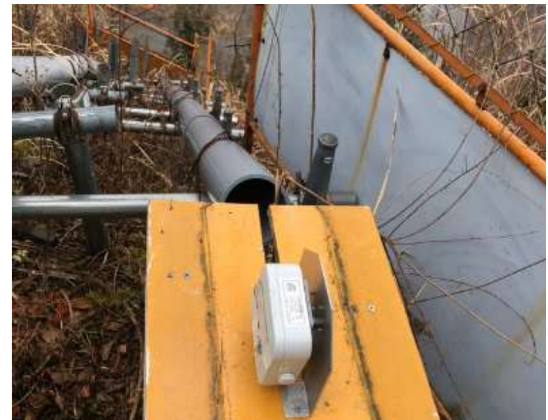
写真 導入事例（上：傾斜 下：OKIPPA伸縮計）
