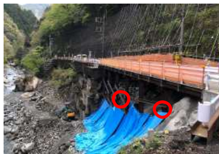
仮栈橋(傾斜計・伸縮計)
