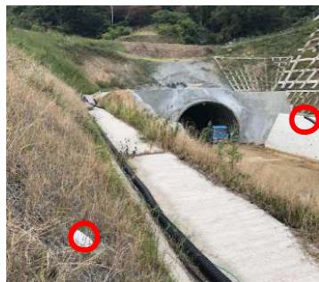
トンネル坑口(傾斜計・伸縮計)
