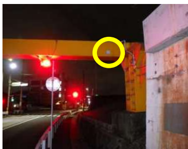
鉄道防護柵の衝撃検知(傾斜計)
