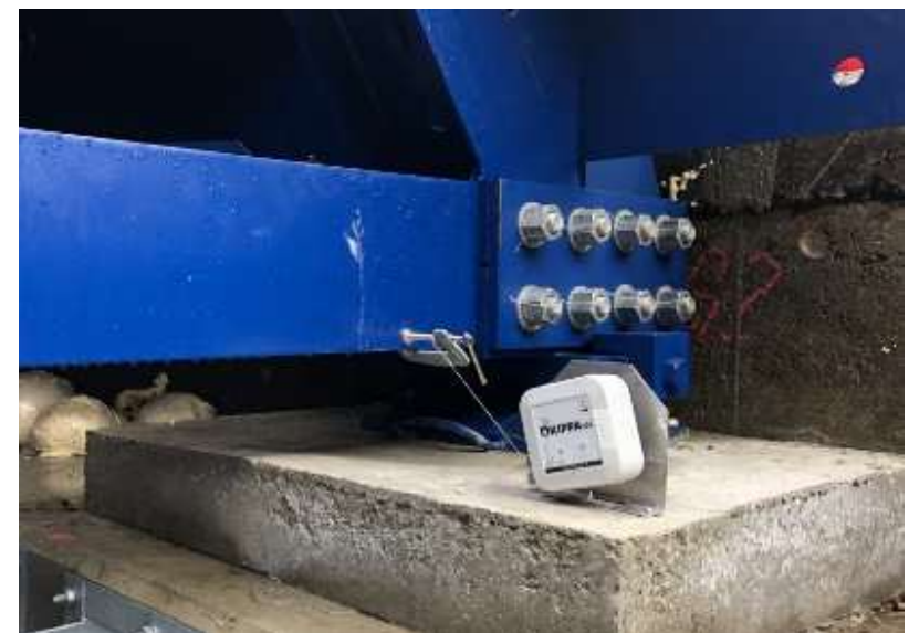
写真 導入事例（上：傾斜 下：OKIPPA伸縮計）
