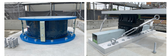
高減衰ゴム系積層ゴム 据え付け状況
